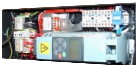
Vue interne du coffret électrique avec son variateur de vitesse
